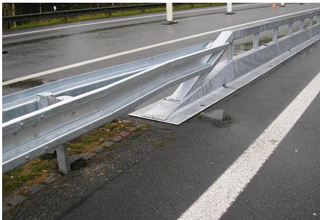
Obrázek 16 - Svodidlo Varioguard – foto napojení na stávající NHKG
